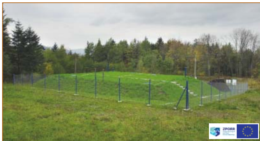
Budowa ujęć, zbiornika i sieci wodociągowej dla Skrzydłnej, Przenoszy i Woli Skrzydlańskiej
