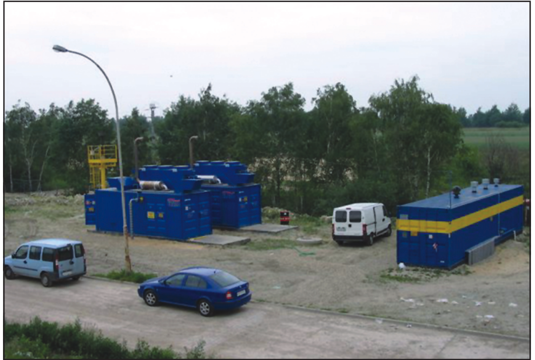
Instalacja do wykorzystania biogazu na składowisku odpadów komunalnych w Tarnobrzegu
